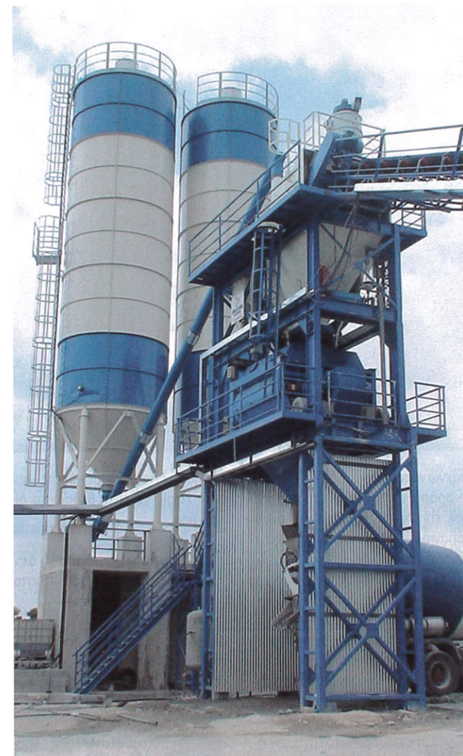
Σταθερό παρασκευαστήριο σκυροδέματος της PROTOM.
